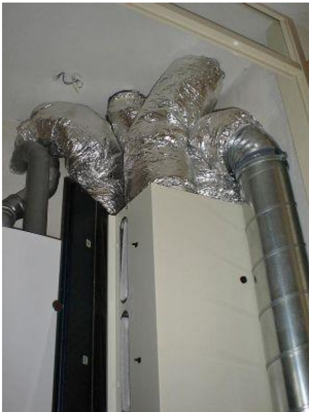
Afb. 6.4 WTW-unit in te kleine opstellingsruimte, te scherpe bochten en onderhoud nauwelijks mogelijk
