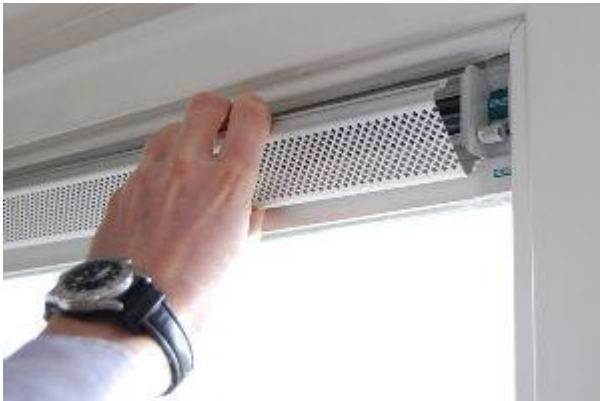
Afb. 7.2 Losnemen binnenwerk toevoerrooster bij natuurlijke luchttoevoer
